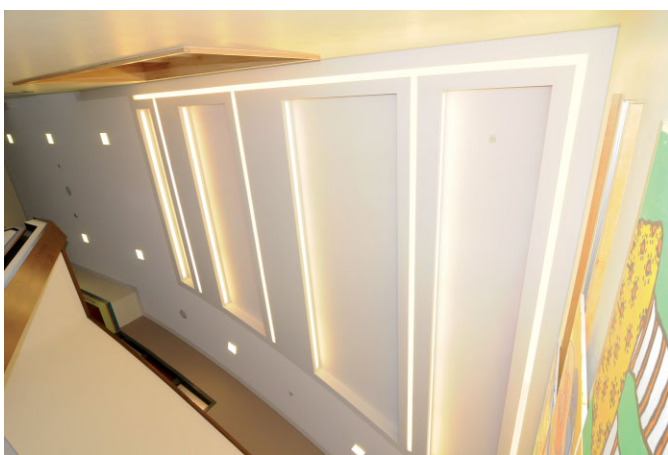
Bild 4. Über dem offenen Treppenhaus ist eine Decke mit Lichtelementen installiert
