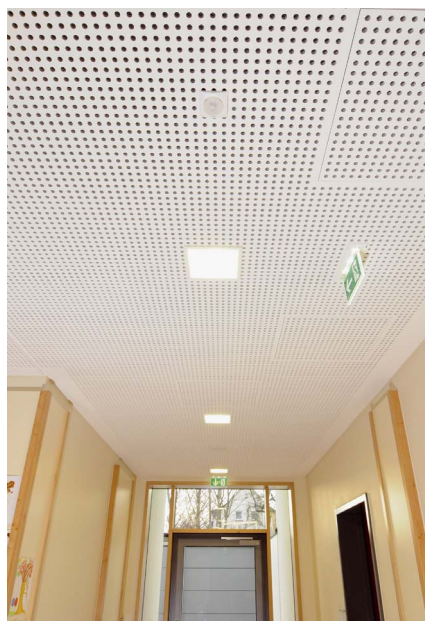
Besonders Schulräume benötigen eine ausgeklügelte Akustik mit entsprechender Deckenlösung.
